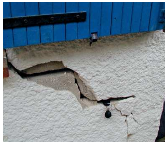
▲ Maison fissurée dans le Pas-de-Calais, août 2003. Sources : BRGM - P. Barchi
