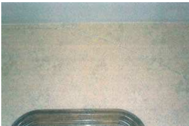
Fissuration intérieure, tapisserie déchirée - Maison André.
