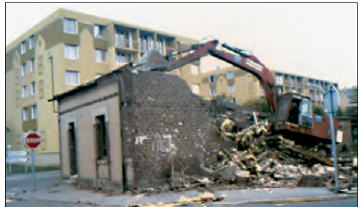
Destruction du poste de police, au milieu des années 1980.
